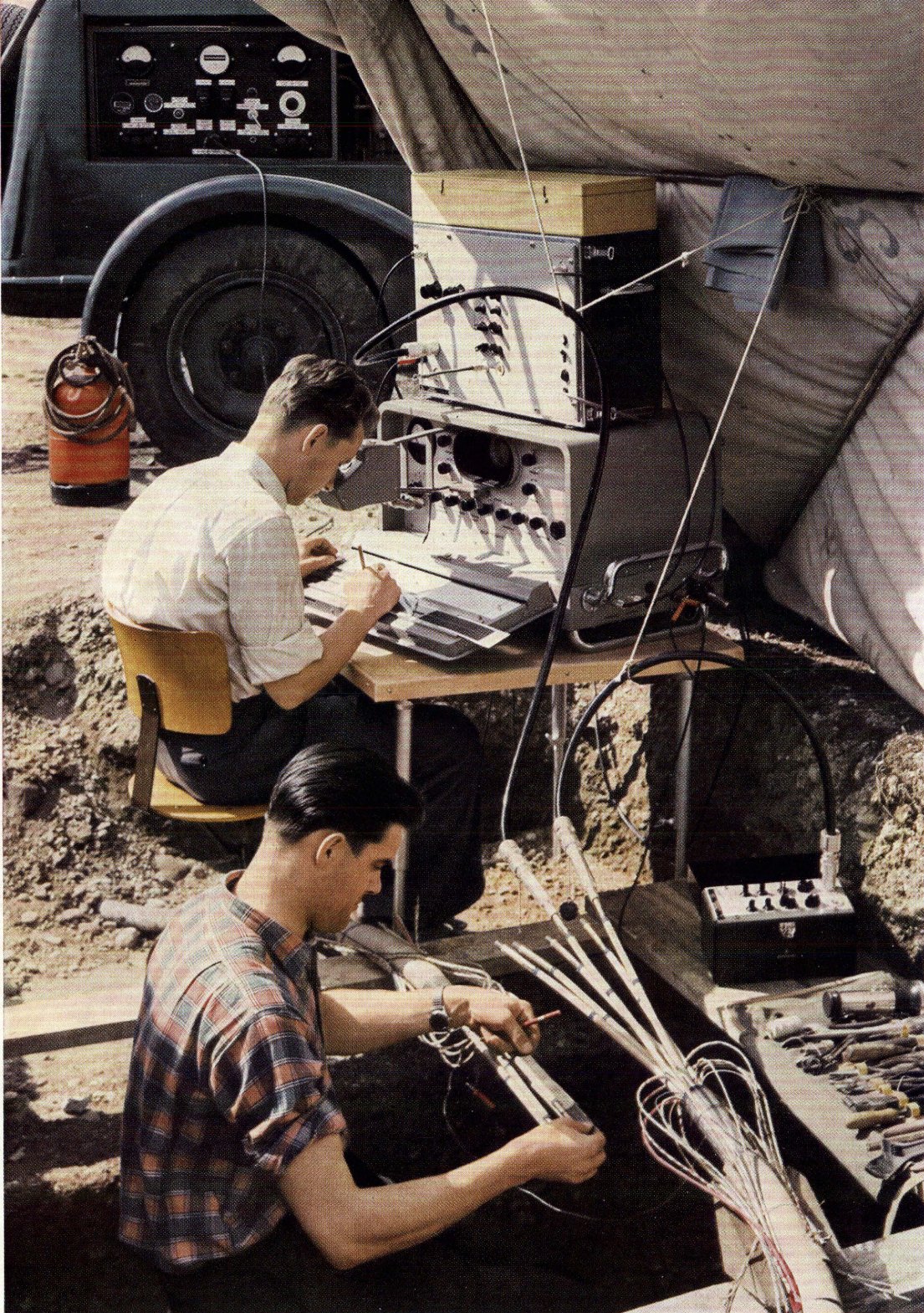
Reflexionsfaktor-Messungen an den koaxialen Paaren eines Nachrichten-Weitverkehrskabels mit dem Reflektographen vor dem Zusammenschalten der Kabellängen in der Verbindungsmuffe
